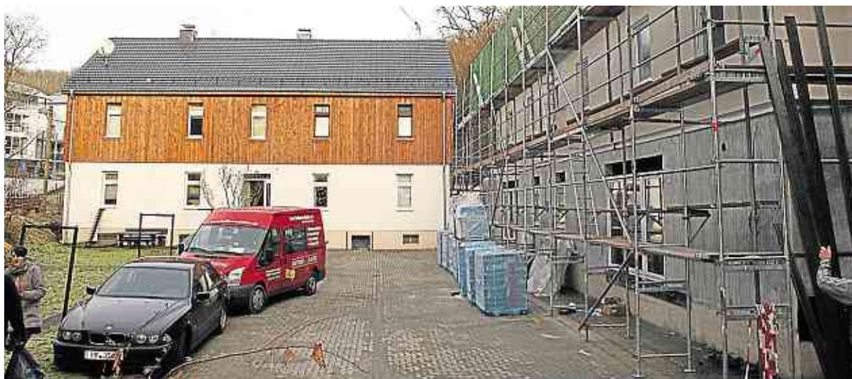
Während der Neubau in der Bröhlstraße (rechts) noch nicht fertig ist, mussten mehrere Mieter der Lebenshilfe ihre Wohnungen im Nachbarhaus (hinten) kurzfristig räumen. Brandschutzauflagen wurden nicht rechtzeitig erfüllt.
