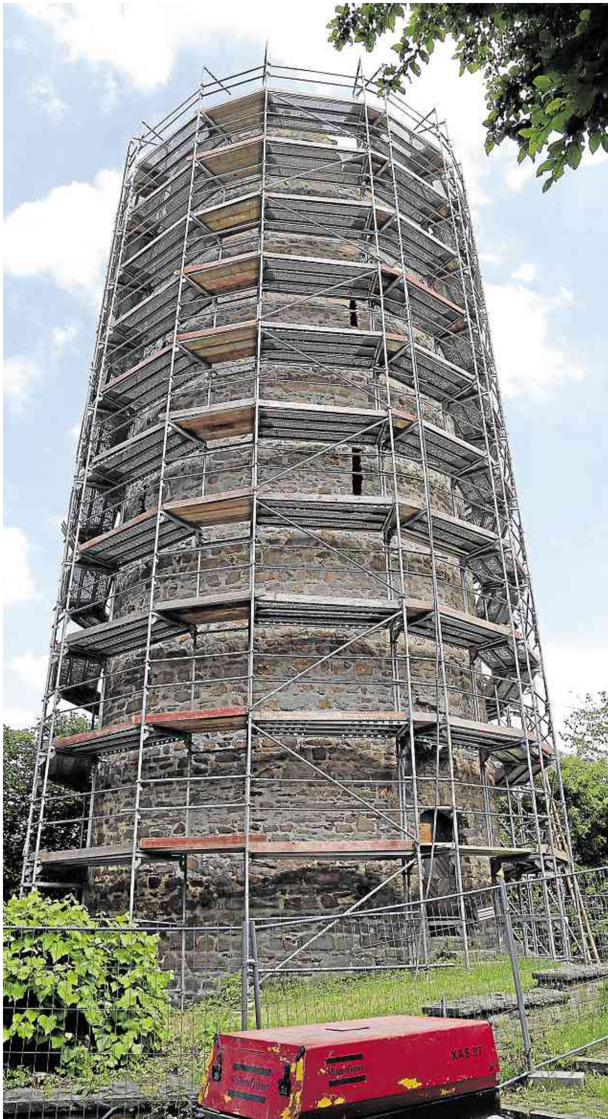
Endlich ist es soweit: Die Burgruine in Burglahr kann restauriert werden. Von weithin sichtbar ist die Einrüstung des 25 Meter hohen Turmes.
