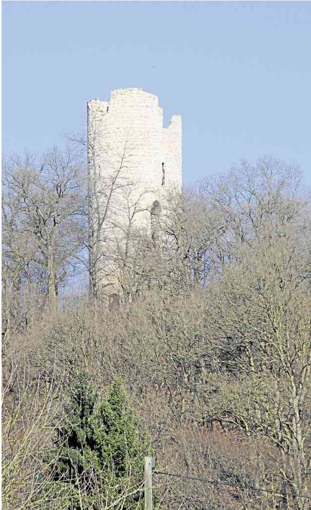
Nach der Demontage des Gerüsts zeigt sich der instand gesetzte Burgturm wieder. Auffallend: Er ist jetzt deutlich heller.
