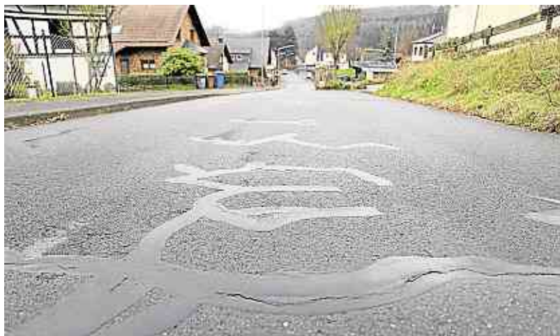
Die Risse in der Kur-Kölner-Straße werden zwar immer wieder repariert, allerdings ohne längerfristigen Erfolg.
